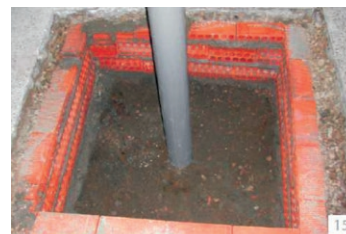
Figura 3 – Ejemplo de arqueta de impulsión ejecutada “in situ” Fuente: Borja Frutos Vázquez
