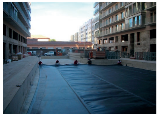
Figura 3 – Colocación de lámina PVC reforzada con poliéster tipo Coreflex XP sobre forjado.
