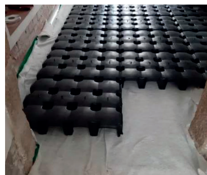
Figura 5 - Ejemplo de disposición de solera ventilada sobre barrera de protección con capa separadora y solera.
