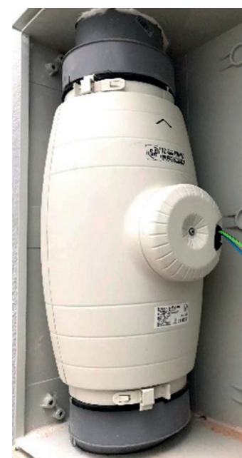
Ilustración 43 - Sistema de ventilación para despresurización del terreno
