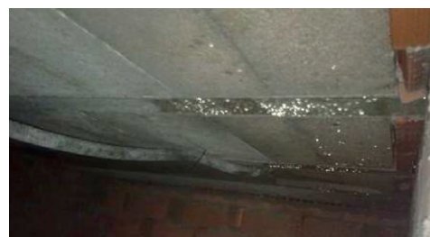
Figura 2 – Ejemplo de forjado sanitario insuficientemente ventilado.
