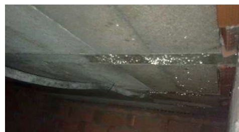
Figura 2 – Ejemplo de forjado sanitario insuficientemente ventilado.
